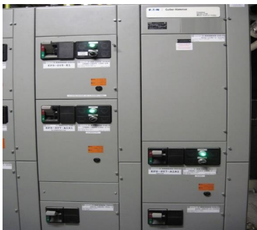
Photo 17. Centre de contrôle moteur (CCM) et démarreurs
