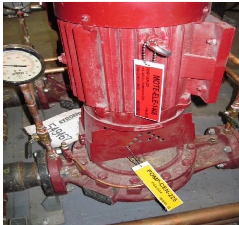
Photo 7. Pompe centrifuge et moteur électrique
