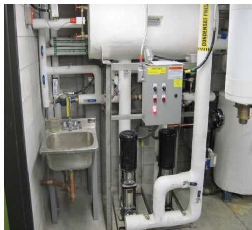
Photo 15. Unité de traitement de condensat
