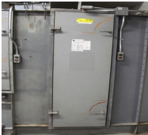
Photo 11. Caisson de filtration
